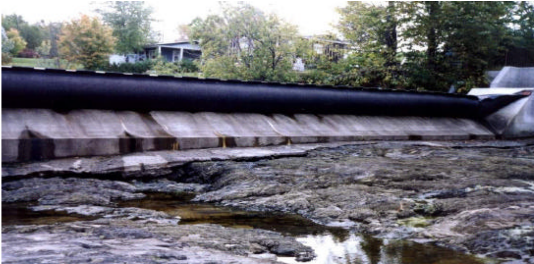
Digue gonflable d'une centrale au fil de l'eau, rivière Nicolet
